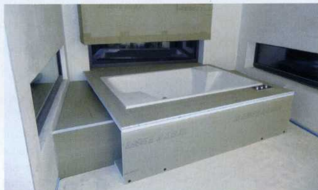
Gut zu erkennen: die diagonale Anordnung der Verkleidung. Die Plattenstärke von 50 mm erlaubt eine Nutzung des Wannenvorbaus als Bank.
