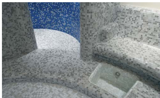
... nach der Fertigstellung. Dahinter ist die ebenfalls mit Hartschaum-Trägerelementen modellierte Wärmebank zu sehen.
