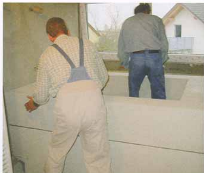
Im Badezimmer fügen die Monteure die maßgeschneiderten Hartschaum-Trägerelemente zu einer japanischen Badewanne zusammen. Die Bautafeln sind beidseitig mit einer mit Glasfasergewebe armierten Mörtelschicht versehen.
